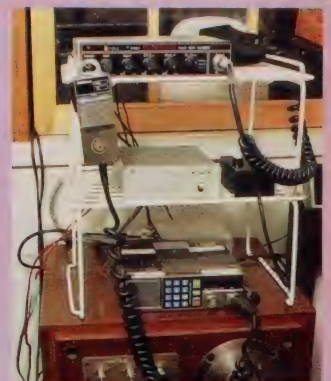
◆FM局の一角に置かれたパーソナル無線機。アンテナは屋外に設置してある。
